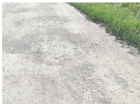
Il manto dissestato in via Settecaminì nella Piana reatina
